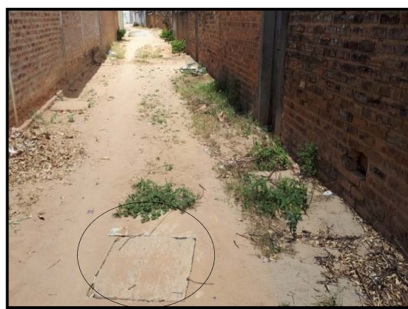
Caixa de passagem
