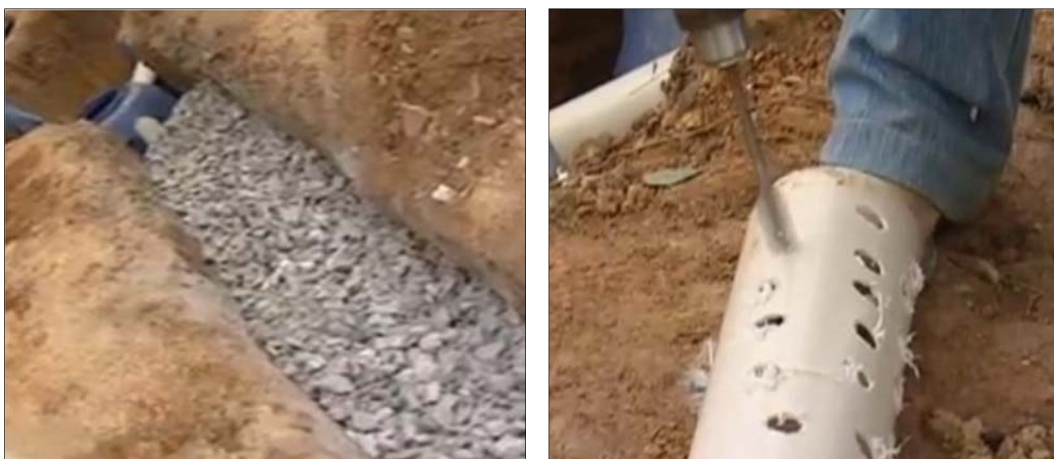
Figura 104 – Vala de infiltração para disposição do efluente da fossa séptica econômica
