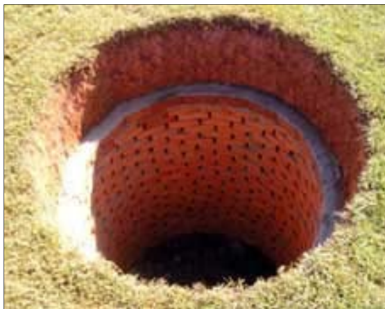
Figura 97 – Tipologia de sumidouro: sumidouro de tijolo
