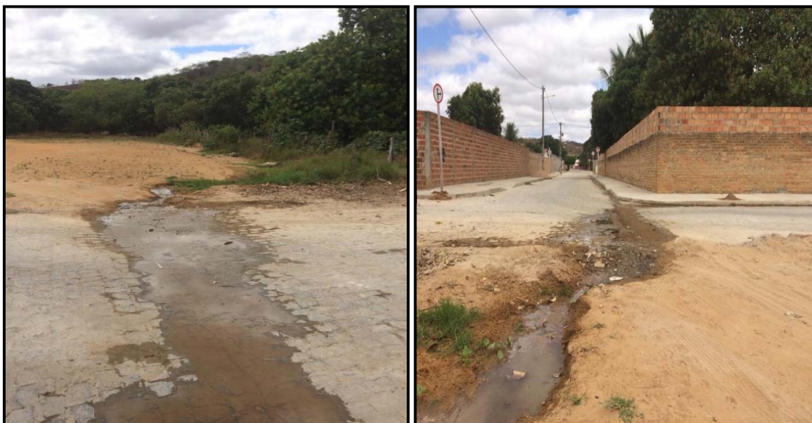
Figura 40—Lançamento de esgoto a céu aberto – sede municipal de Banzaê/BA.
